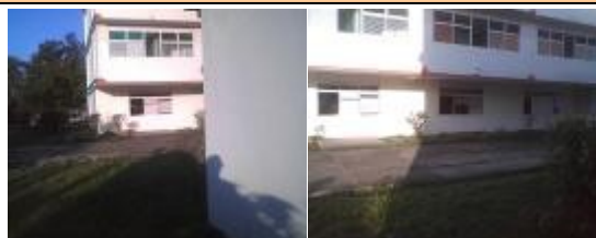
Imágenes del deterioro de una unidad hospitalaria
