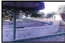
Botes de agua que no funcionan
