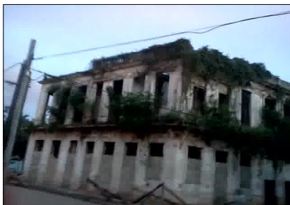
Otrora Fábrica Pasta Dental Gravi situada en Calle 9B esquina a 14 en Jovellanos, Matanzas.
